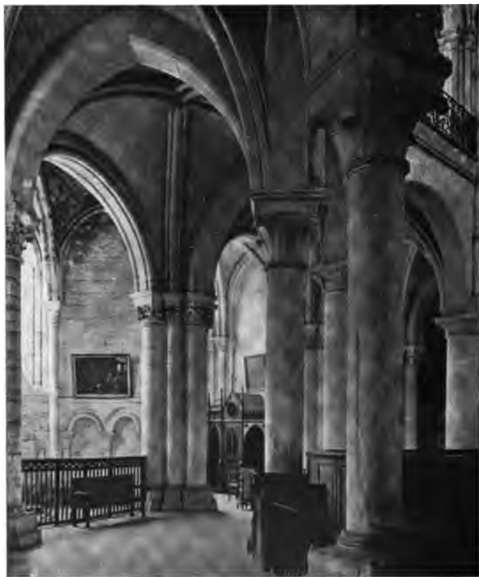
Fig. 148. — Voûte du déambulatoire à l'ancienne cathédrale de Noyon. Adaptation parfaite des chapiteaux aux retombées des arcs diagonaux doubleaux et formerets.
